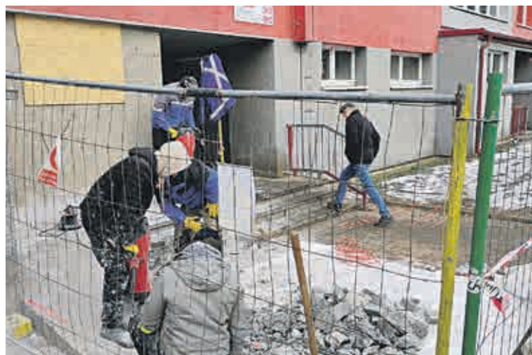
Rozjezd investic. Jednou z prvních smluv, kterou už loni na podzim nové představenstvo podepsalo, byla zakázka na částečné zazdění průchodů v bloku 525 (SVJ) v Mostě. Na snímku realizace.
