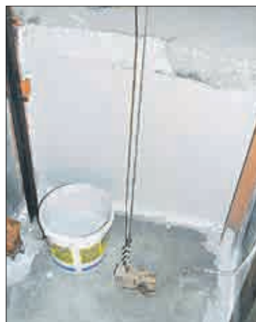
Výtahová šachta chráněná „vanou“ před pronikající spodní vodou.
